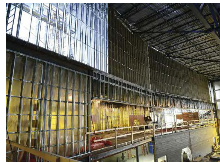
Aréna faisant face à l'ouest – utilisation intensive de sections en acier usiné à froid sur les murs extérieurs.
