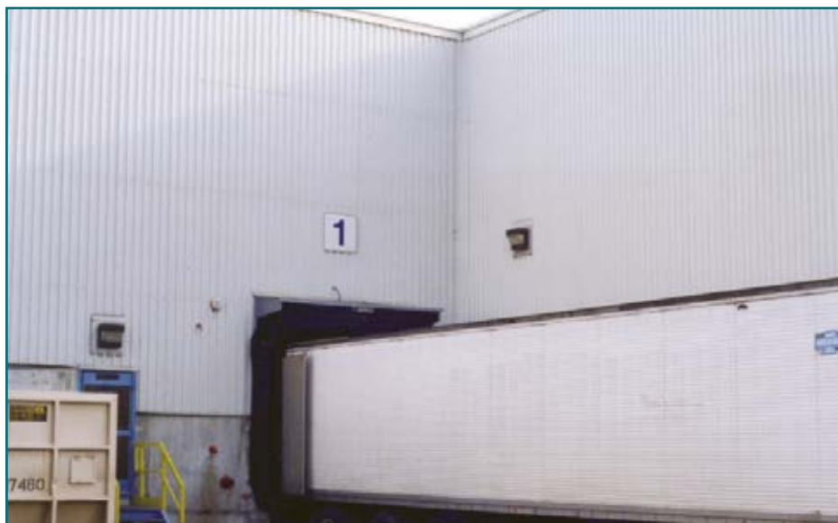
Figure 6: Usine de papiers fins Kraft, bâtiment de finition de papier. Comparaison entre un revêtement neuf et un revêtement de neuf ans. Le revêtement neuf est à droite. Localité: nord du Québec.
