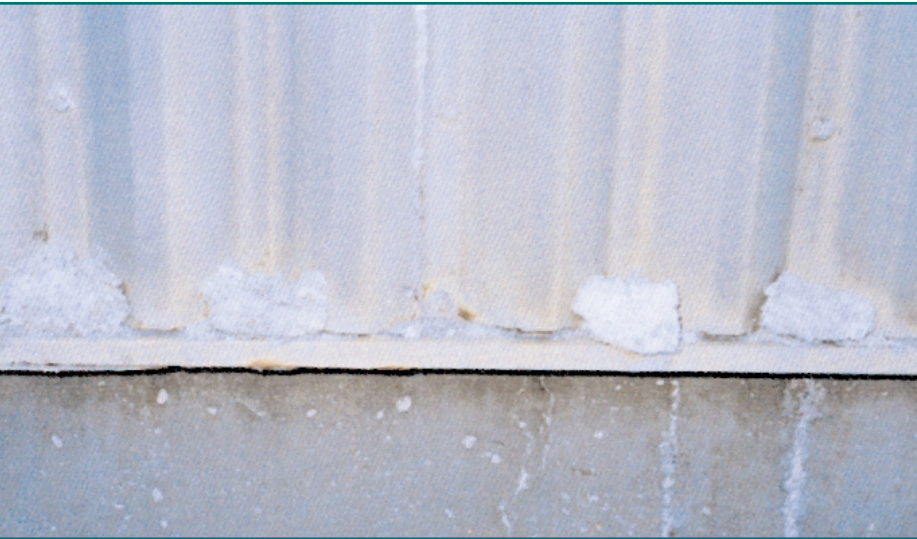
Figure 4: Usine de pâtes et papiers, bâtiment de la chaudière de récupération. Orientation ouest du rez-de-chaussée en-dessous du conduit d'échappement, montrant l'accumulation de polluants et le léger fluage des rives du revêtement. Onze ans d'exposition dans le nord de l'Ontario.
