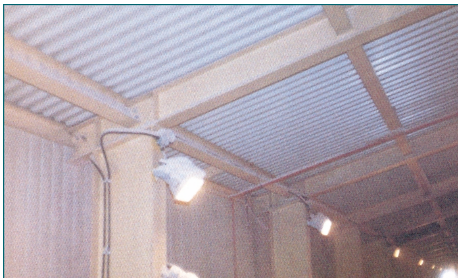
Figure 7: Usine de potasse, intérieur d'un entrepôt de minerai brut. Un environnement chaud et humide contenant de la poussière de potasse. Noter les dépôts de potasse sur les appareils d'éclairage. Onze ans d'exposition en Saskatchewan.
